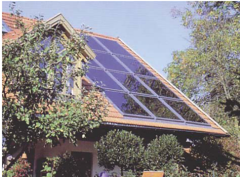
Capteurs solaires plats Giordano. Il est indispensable de penser aux surfaces de capteurs dès la conception du projet pour une bonne intégration.
